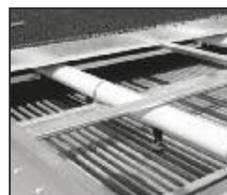
Tropfenabscheider wurde entfernt für die Inspektion des Rohrschlangenwärmetauschers
